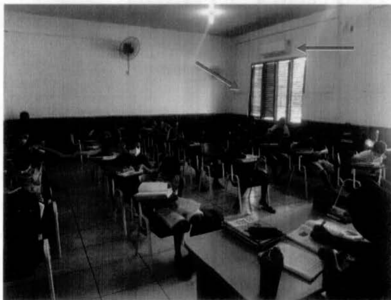
Imagem 02 – Janelas venezianas de madeira a ser substituídas e Instalação elétrica para ar-condicionados para serem refeitas.
